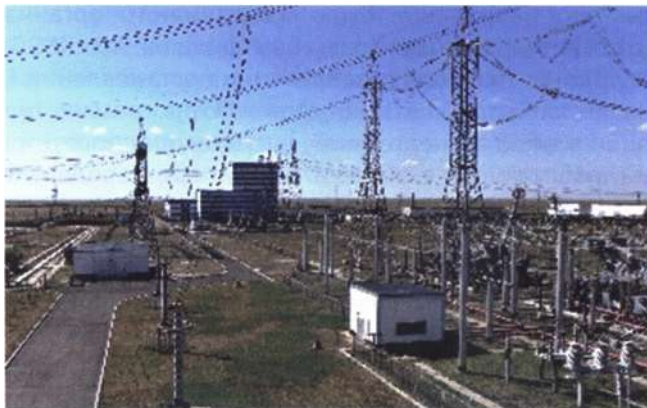
ПС-1150 кВ «Экибастузская»
